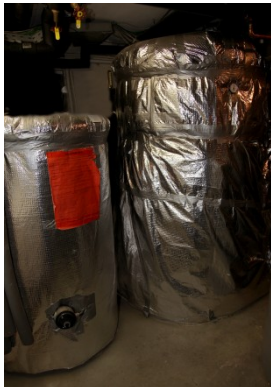
Zusatzisolierung der WW-Speicher
